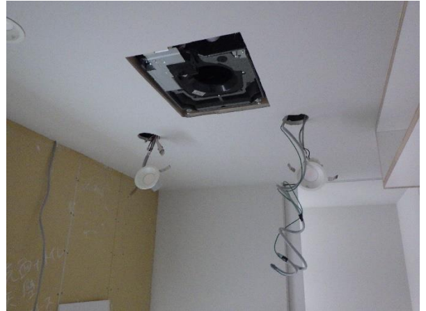
引き渡し時の照明機器が未設置、石膏ボードなどがむき出しになっている様子。
