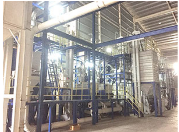
設備写真(石抜機など)
