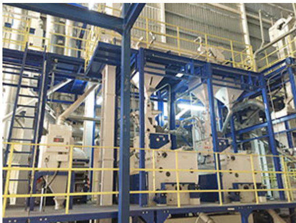
設備写真(粃摺機など)
